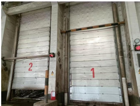
图3.5-4 卸料门现场照片
