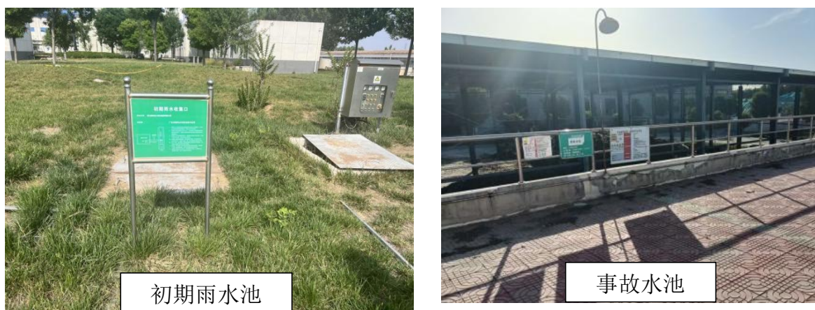
图4.2-5 初期雨水池、事故应急池
