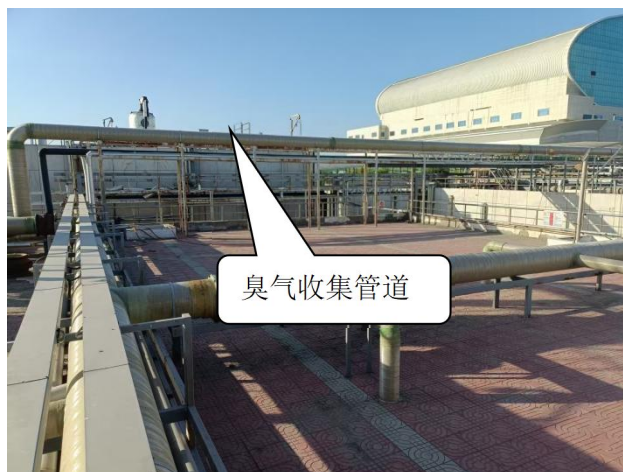
图4.1-8 渗滤液处理站恶臭收集现场照片
