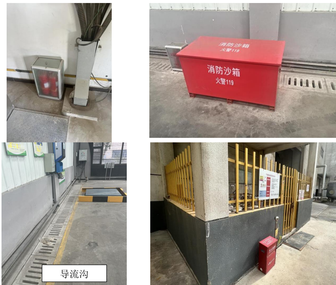
图4.2-7 消防设施及部分应急物资
