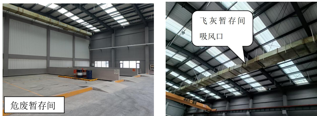
图4.1-11 危废暂存间、飞灰暂存间照片
