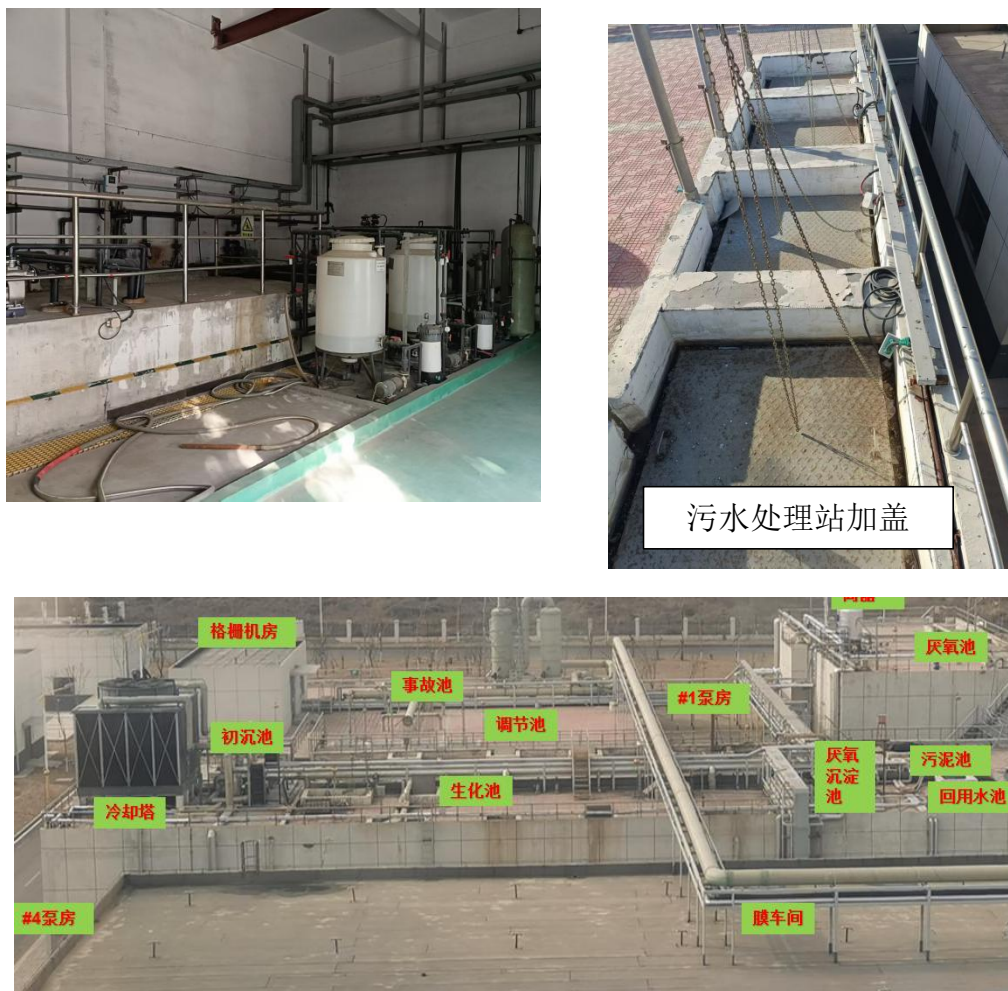
图4.1-16 生活污水处理站
