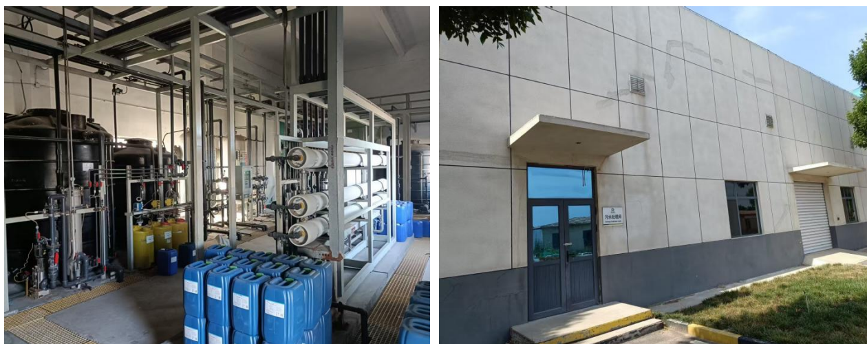
图4.1-14 工业废水处理站现场照片
