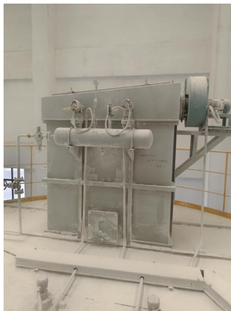
半干法石灰仓顶布袋除尘器
