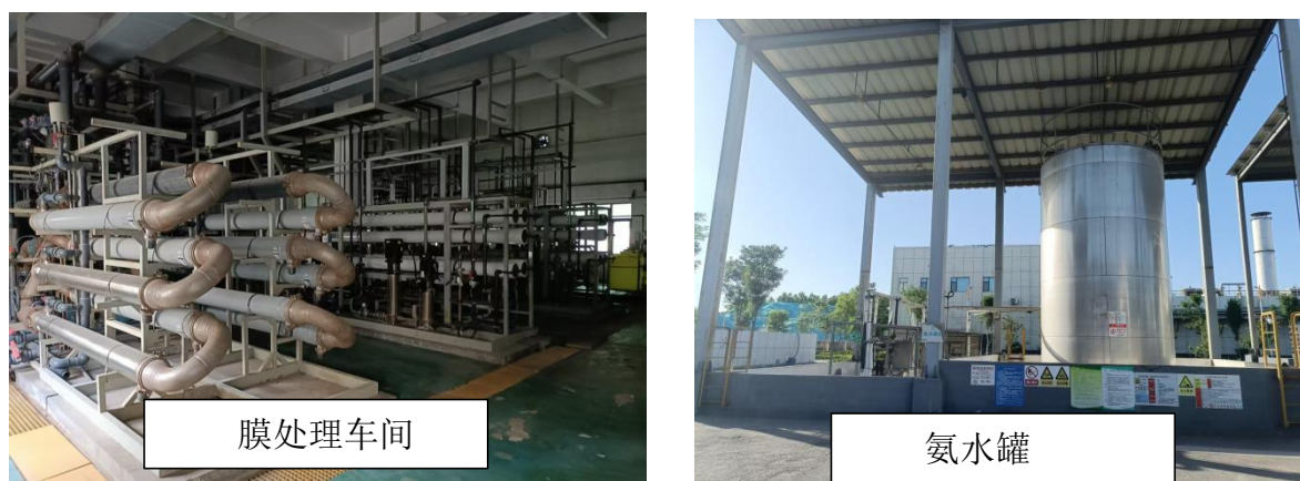
图4.1-12 渗滤液处理站现场照片
