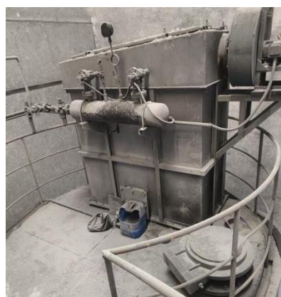
活性炭仓顶布袋除尘器
